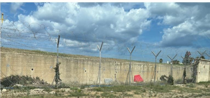
El muro norte sustituido con una malla metálica
